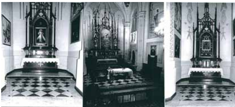
▲ Remont posadzki oraz krypty w prezbiterium i kaplicach bocznych w kościele parafialnym p.w. Św. Bartłomieja Apostoła w Grębkowie (2016 r.)
